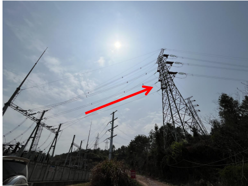
线路经过平地走线现状
