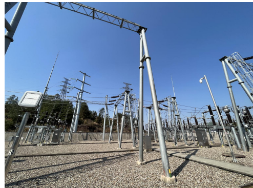
110kV 配电装置区
